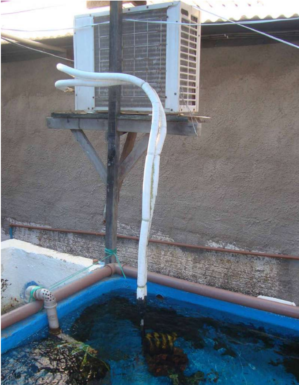
Figura 67. Adaptação de aparelho de ar condicionado com central eletrônica de controle de temperatura regulado por sonda aquática, para monitoramento da temperatura da água em tempo real.
