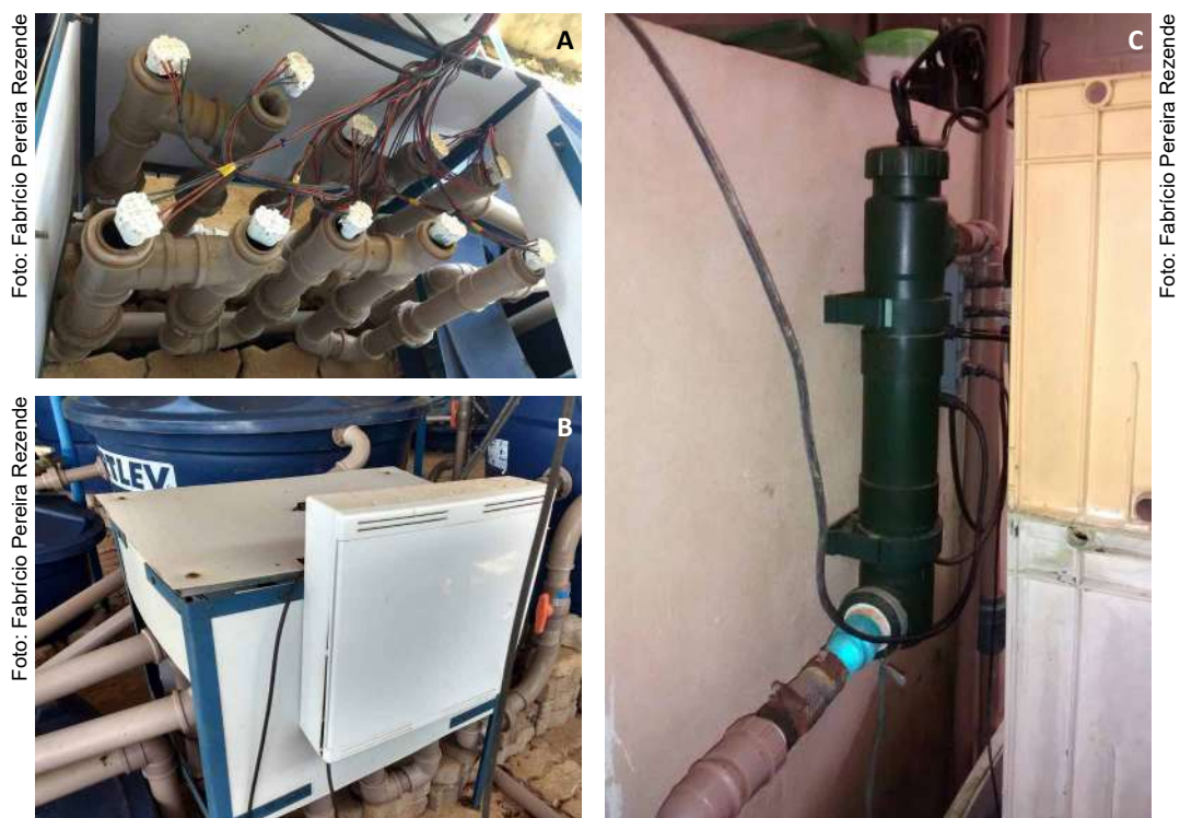
Figura 63. Vista panorâmica das tubulações hidráulicas (A) de um filtro germicida de irradiação ultravioleta multilâmpada em RAS de grande volume (B); filtro ultravioleta monolâmpada aco-plado em sistema de filtragem (C).
