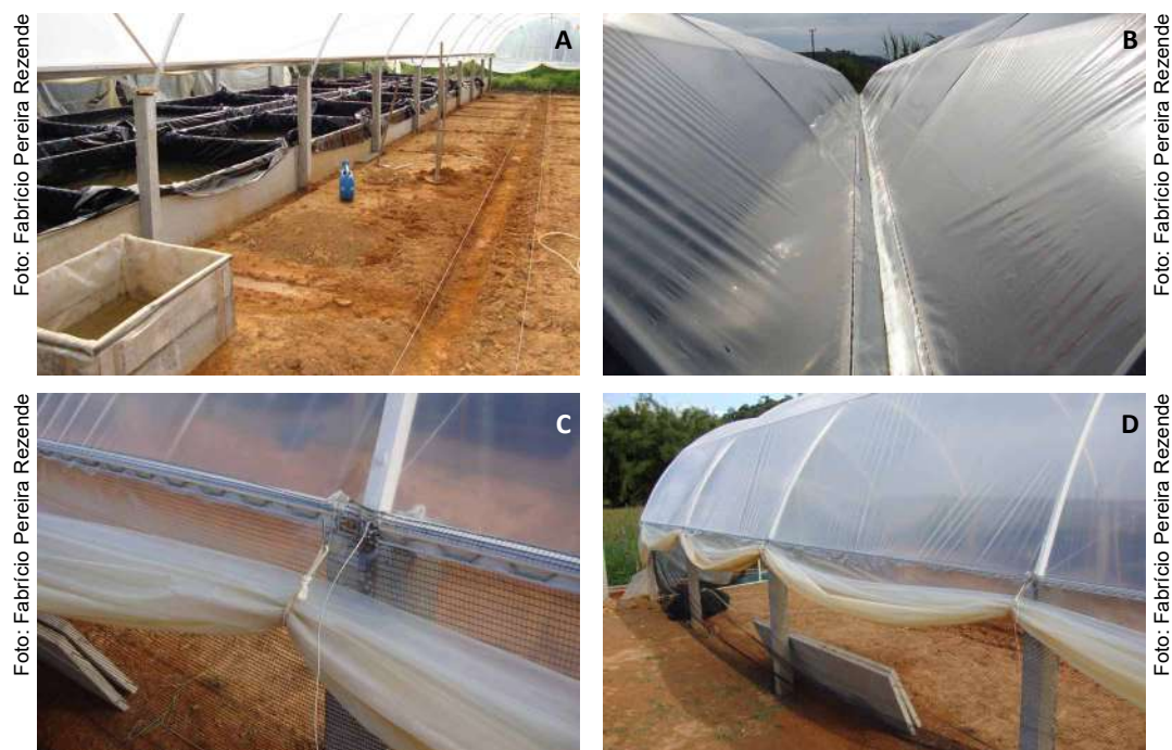
Figura 64. Vista geral de uma estufa e marcação interna da posição das placas de concreto que vão compor os tanques (A); sistema de drenagem de chuva entre estufas geminadas (B); canaleta de alumínio para fixação de lona com mola e ponto de fixação de cortina lateral (C); vista da lateral de estufa com a cortina suspensa e tela sombrite já instalada antes da montagem dos tanques de concreto (D).
