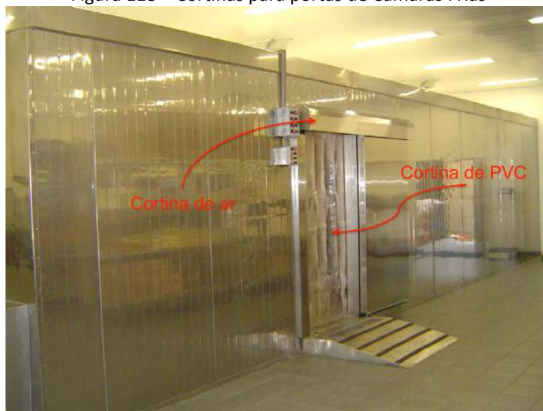
Figura 118 – Cortinas para portas de Câmaras Frias
