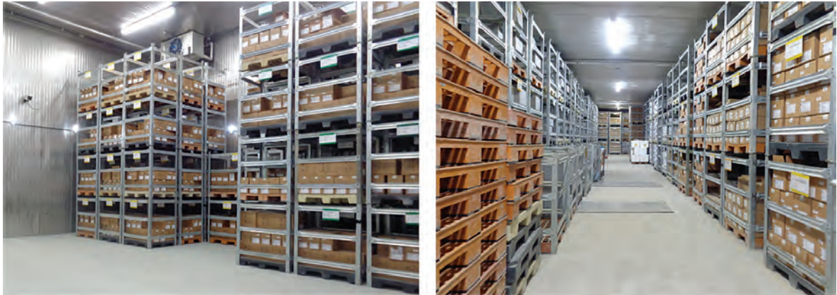
Figura 27 Câmara fria positiva (visão interna)
